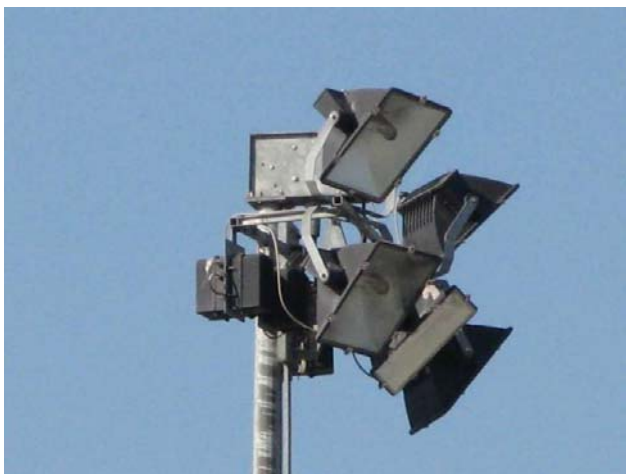
Foto: Impianto di illuminazione non a norma
