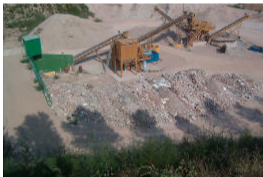
Foto 5: Impianto per la frantumazione dei rifiuti inerti
